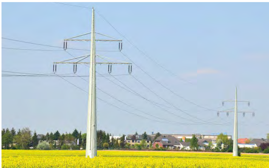
Um die dezentrale Energie aus Wind und Sonne zu sammeln, zu transformieren und in das Stromnetz einzuspeisen, ist der Neubau von Umspannanlagen notwendig
