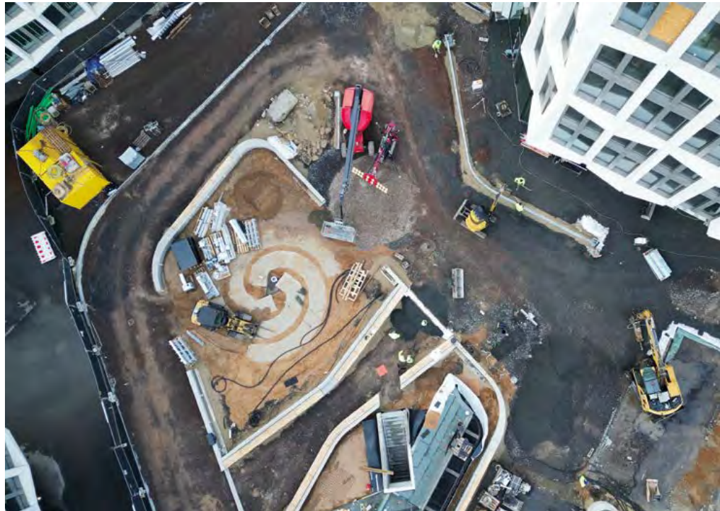
Der Neue Kanzlerplatz mit den individuellen Entwässerungslösungen von ACO Inotec
