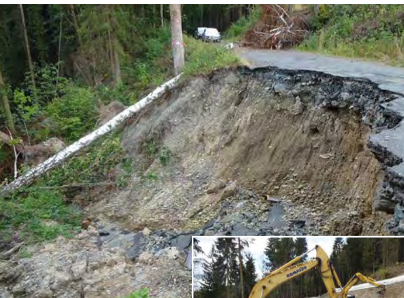
Böschungsrutschung im Bereich der Leubethaer Straße
